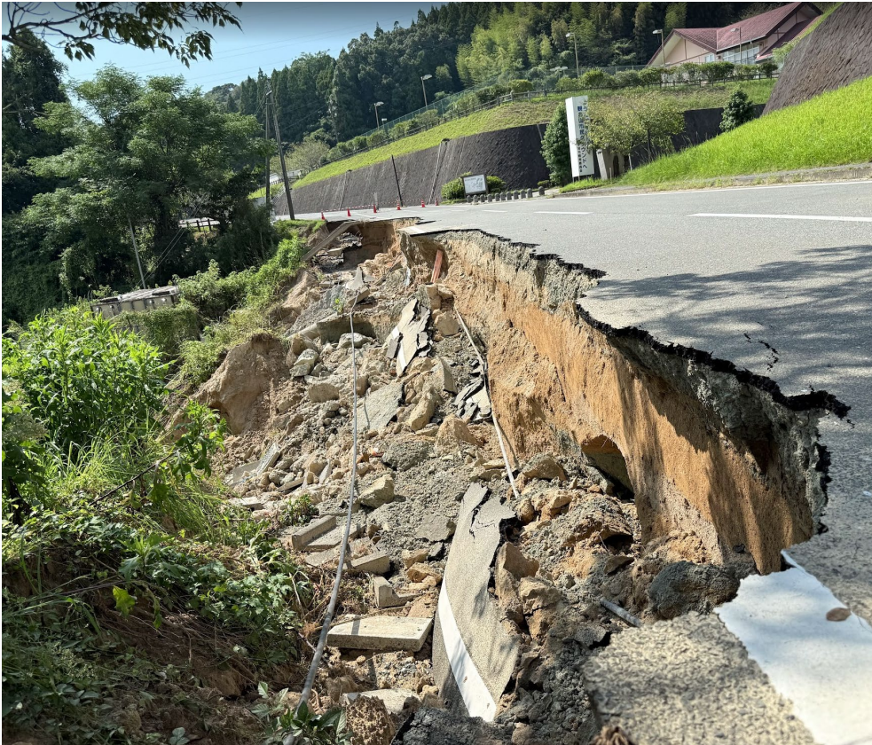
宇城市観音山総合運動公園 2025年8月16日14:00ごろ 施設入口の道路が陥没
